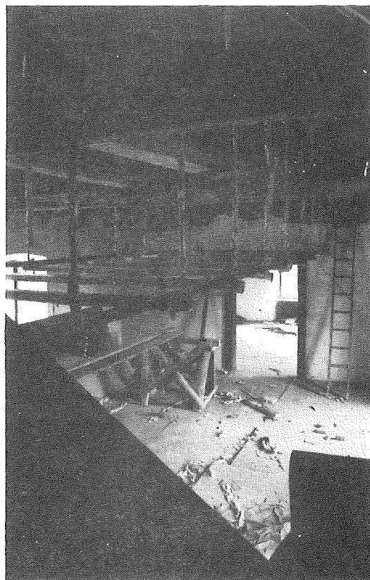
Slika 3: Pogled s stopnic na osrednji prostor zbirke z vhodom v prehodno sobo in na kovinsko konstrukcijo viseče galerije.
